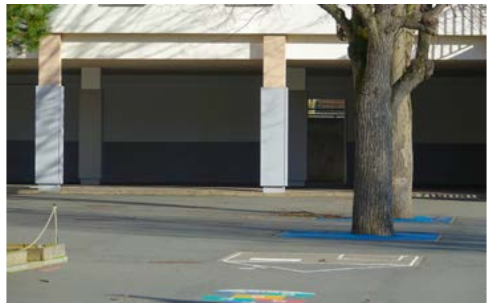
Le préau de l'école Saint-Éxupéry a lui aussi bénéficié de travaux de peinture.
